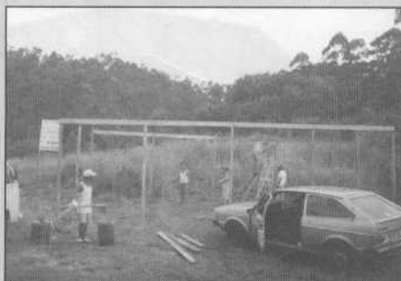
A primeira construção no terreno da Creche do Recanto, no Embu, numa época em que não havia nem energia elétrica na região
